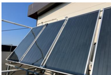
写真 太陽熱集熱器外観
